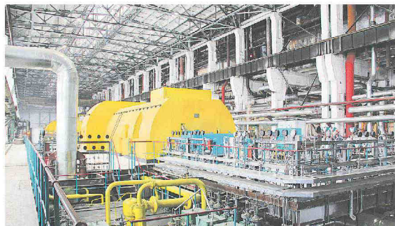
Новый турбоагрегат №5 мощностью 95 МВт, сменивший старую турбину фирмы «Шкода» (Чехословакия), установленную в 1965 году
